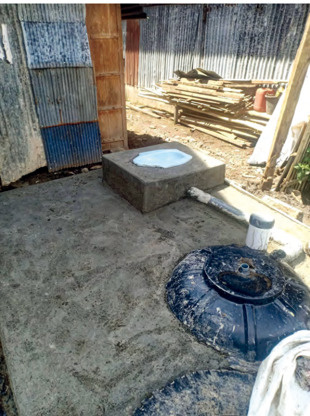
Instalasi jamban dengan tangki septik yang berstandar SNI di Kabupaten Pinrang. Foto: Halia Asriyani/ Yayasan BaKTI
